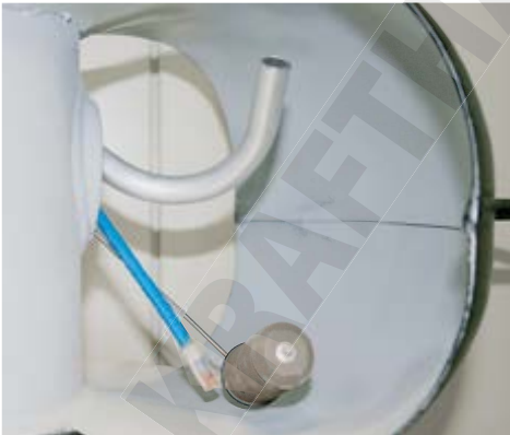
▲ Abbildung 76: Eingebautes Multiventil mit Entnahmeschlauch nach unten.
